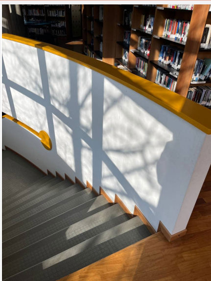
Rampa di scale che porta al piano interrato dal piano terra privo di corrimano nel lato destro nei primi 2,5 m di scale
