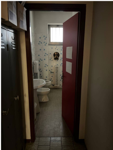
Bagno del personale non adeguato accesso solo da parte del personale e spazio sufficiente per eventuali adeguamenti
