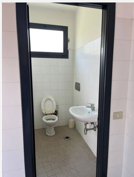
Bagni con accesso dalla seconda porta da destra dell'edificio senza accorgimenti per utenza con disabilità
