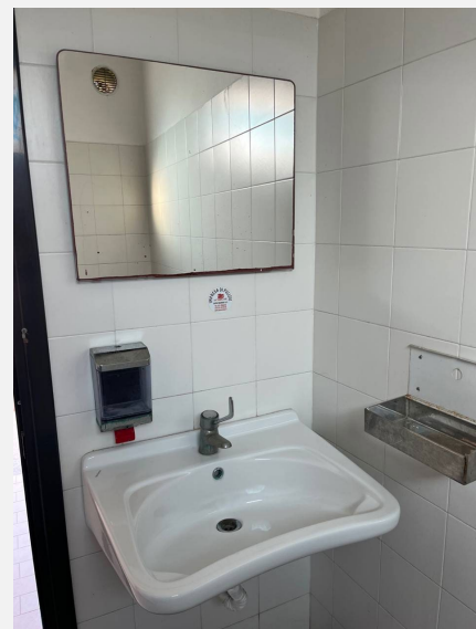
Bagno riservato in corrispondenza di prima porta a destra dell'edificio con specchio troppo alto non utilizzabile da utenza in carrozzina
