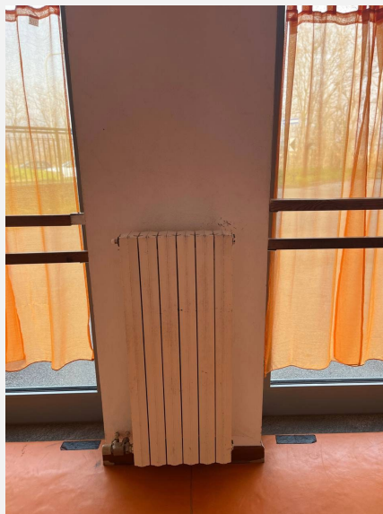
Palestra di danza facente parte dell'edificio centro sociale con all'interno i sette caloriferi da 1 x 1,3 m caloriferi da 0,4 x 1 m
