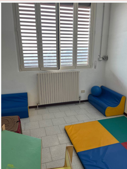
Aula primo piano vicino a uscita di emergenza ex aula covi d' con termosifone privo di protezione
