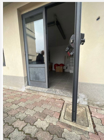
Ingresso del personale con all'esterno un dislivello doppio su marciapiede e su soglia e all'interno una scalinata, complessivamente non accessibile.
