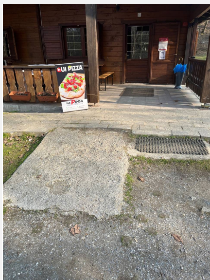
Area esterna parzialmente accessibile per rampa in cemento sconnesso
