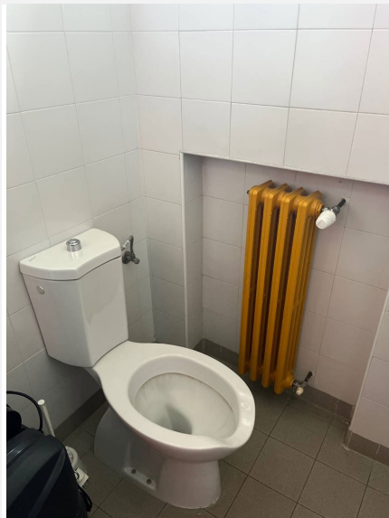
Bagno riservato piano -1 con wc privo di ciambella
