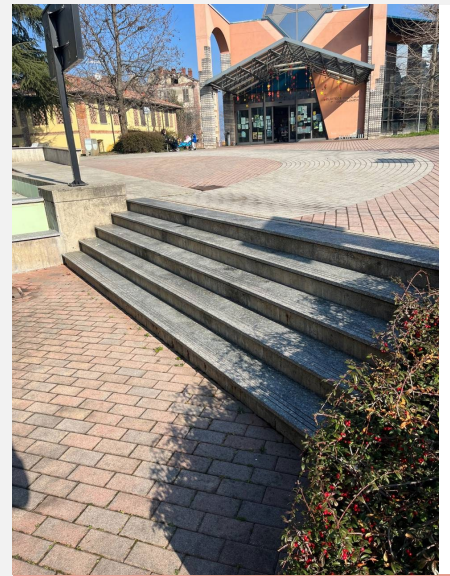
Scalinata che collega piazza ad accesso del Comune privo di corrimano
