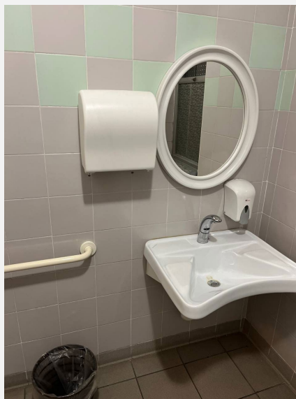
bagno riservato a norma con specchio sufficientemente basso ma non agibile in quanto sono presenti i problemi nei tubi di scarico dell'acqua
