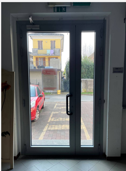
Sala riunioni con unica uscita di emergenza con serratura non a norma
