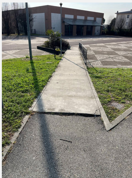
Accesso a area mercatale da parcheggio in via donatori volontari di sangue con rampa non accessibile per dislivello di 5 cm
