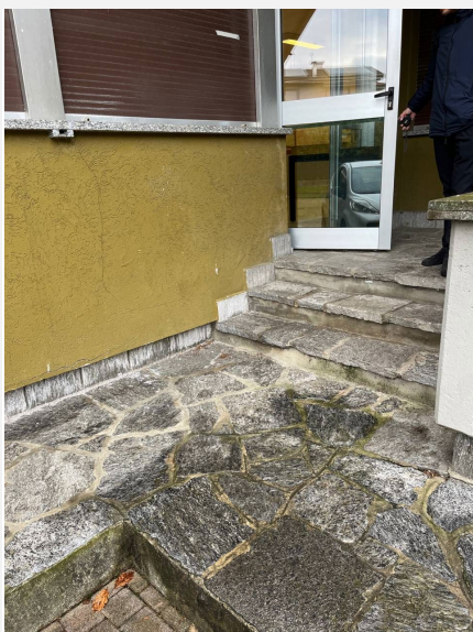
Porta uscita emergenza dall'atrio centrale con tre scalini non accessibile
