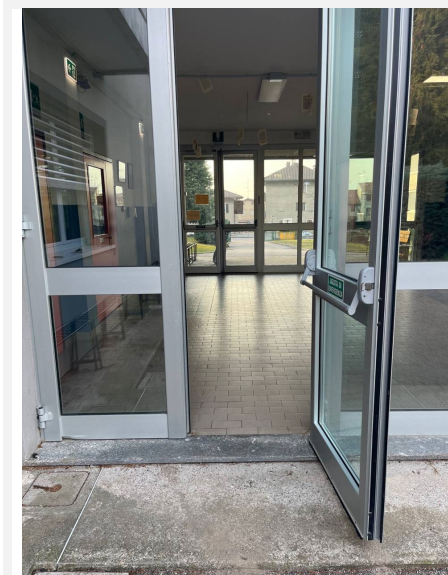
Uscita di emergenza di fronte all'ingresso principale della scuola elementare con dislivello su soglia maggiore di 3 cm
