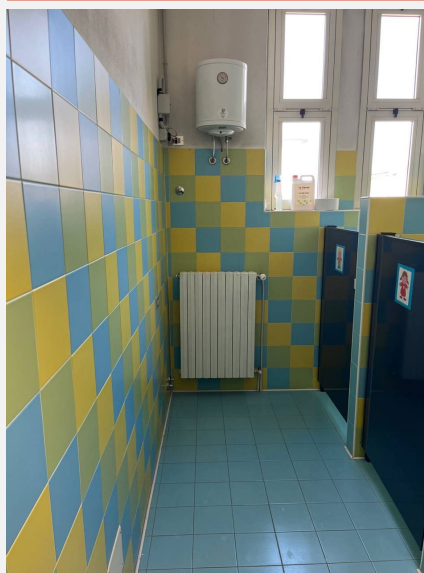
Termosifone primo piano bagno privo di protezione
