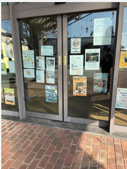
Ingresso principale con gradino di oltre 3 cm sulla soglia
