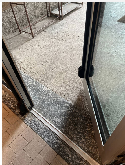
Uscita di emergenza piano -1 in prossimità di scalinata dell'uscita di emergenza di piani superiori con dislivello maggiore di 2,5 cm
