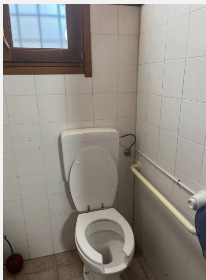
Bagno riservato per il pubblico femminile a norma con assenza di sistema chiamata di emergenza
