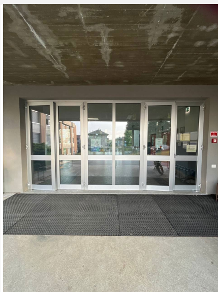
Ingresso principale con dislivello maggiore di 3 cm
