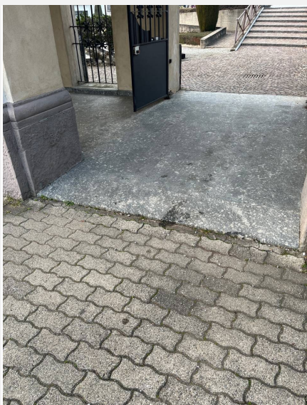
Ingresso con dislivello di 3 cm; ricarica in asfalto di 2,5 m per eliminazione del dislivello
