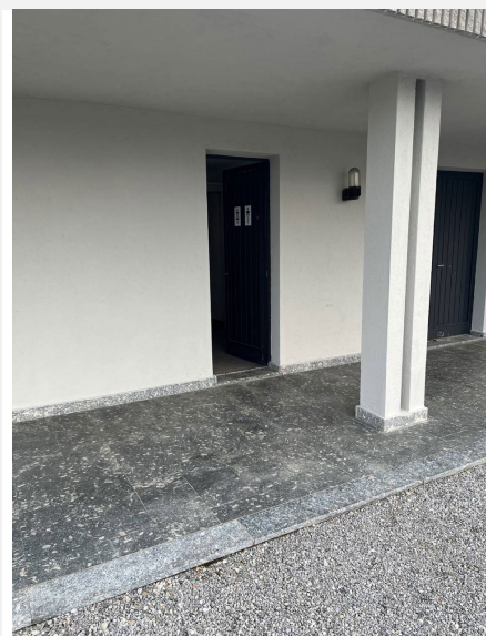
Assenza di bagno riservato. Unico bagno disponibile su area non accessibile e gradino su soglia maggiore di 3 cm
