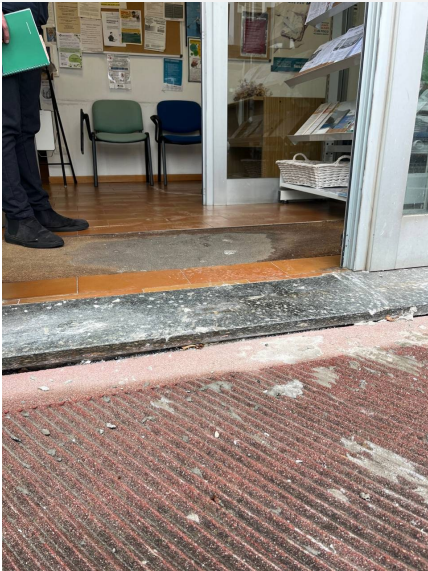
Dislivello di 3 cm su soglia ingresso principale; posizionamento zerbino
