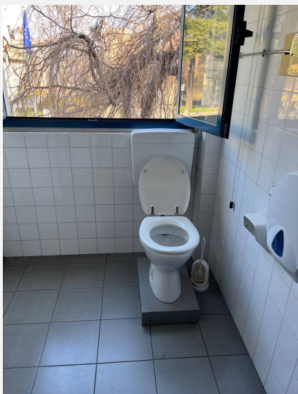
Bagno disabile primo piano privo di maniglione di appoggio
