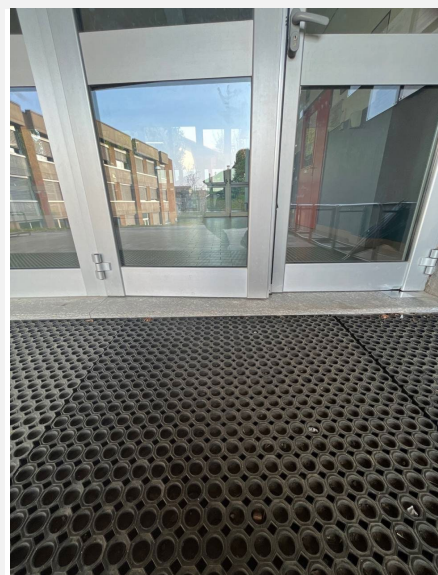
Ingresso principale con dislivello maggiore di 3 cm
