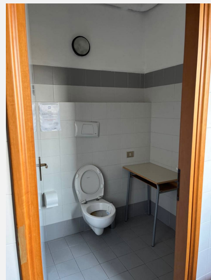
Bagno riservato collocato nell'area della sala riunioni non adeguato (Wc non a norma, sistema chiamata allarme guasto e maniglione d'appoggio collocato troppo distante dal wc)
