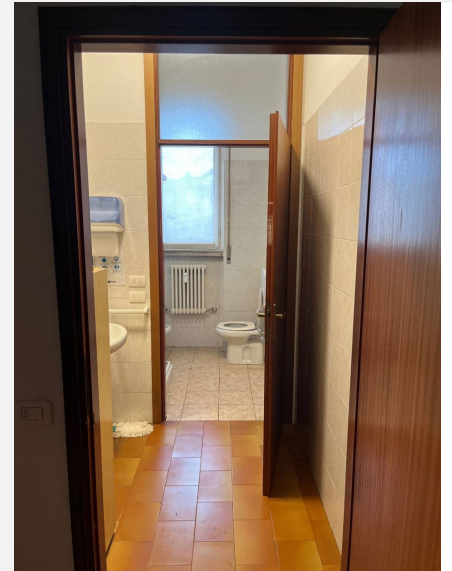
Assenza di bagno riservato. Dimensioni del bagno possono consentire l'adeguamento
