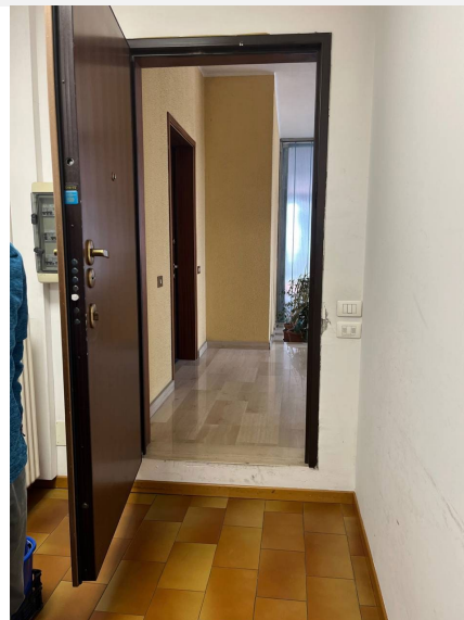
Porte di collegamento fra condominio e uffici Cisl utilizzata soltanto dal personale
