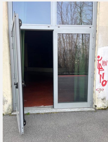
Uscita di emergenza sala musica a norma da riparare serratura e sistema di chiusura del maniglione che ha qualche difetto
